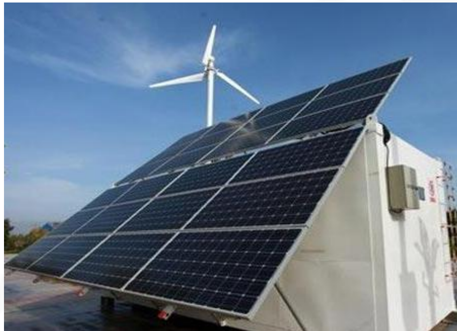
光伏储能电站
